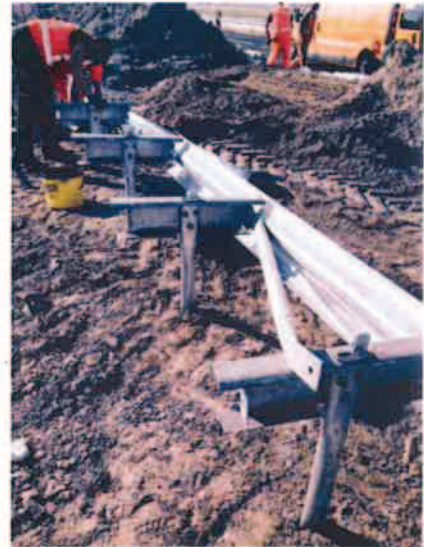
Diagonaal- en opzetstukken op paal gemonteerd
